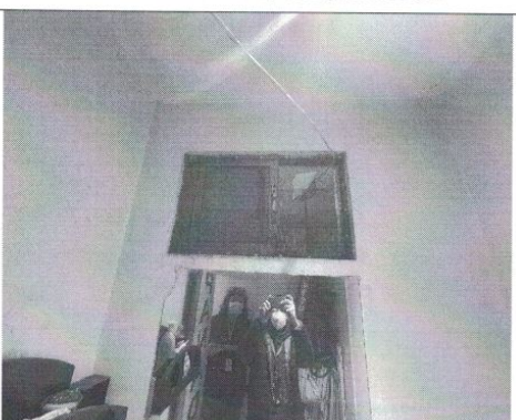
Detalle de ventana de baño de local B, se observa comunicación con un recinto techado, discordante con las condiciones aprobadas en permiso que detalla un patio descubierto.
