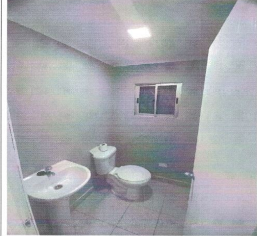
Baño de local comercial 2, se encuentra con ventana clausurada, discordante con planimetría.
