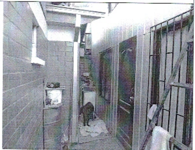
VISTA EXTERIOR DE EDIFICACIÓN NO DECLARADA
