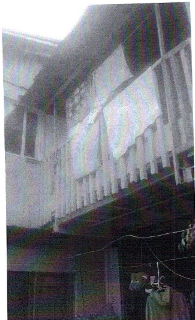
Fotografía 4. Ampliación segundo nivel no declarada en planos.
